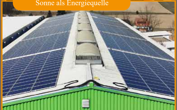
gekühlte Produktionsräume Sonne als Energiequelle
